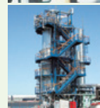
廃液・廃ガス 燃焼装置
