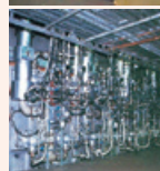
連続焼鈍設備用 HRSRTバーナ
