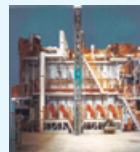
2階建AL鋳物T6 熱処理炉
