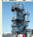
廃液・廃ガス 燃焼装置
