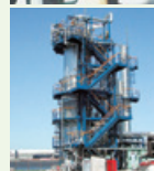
廃液・廃ガス 燃焼装置
