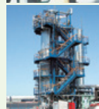
廃液・廃ガス 燃焼装置
