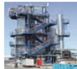
廃液・廃ガス燃焼装置
