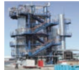
廃液・廃ガス燃焼装置
